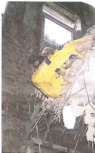
Eingebrochene Geschosdecken in der Heinrichstraße 40: Auch in diesem Fall ist eine Sanierung nicht mehr möglich.
