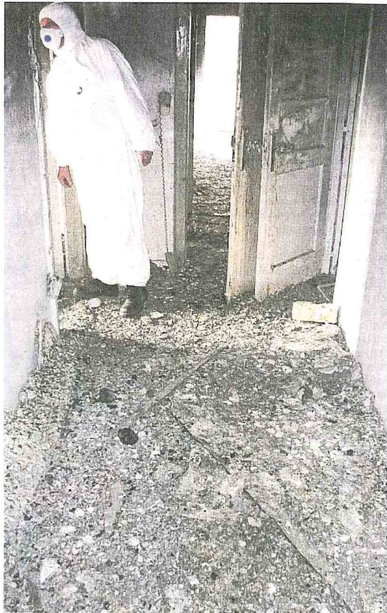
Nur mit Ganzkörperschutz und Gesichtsmaske betritt ein Baugutachter das Haus in der Bremerhavener Straße 3. Die Stadt hat das Gebäude in der Zwangsversteigerung erworben und lässt es abreißen.
