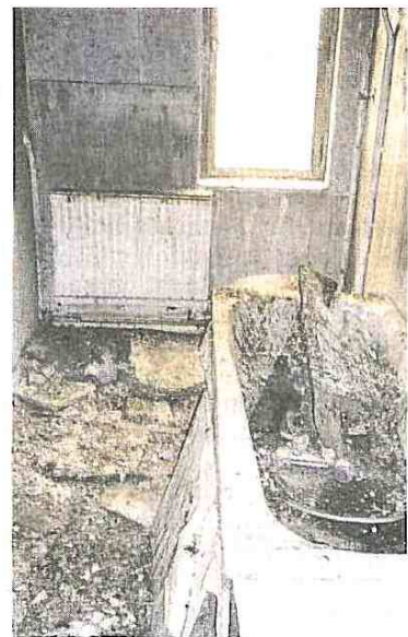
Das war mal ein Badezimmer: Vogelkadaver und zentimeterdicker Kot in der Bremerhavener Straße 3. Das Haus ist nicht zu retten.
