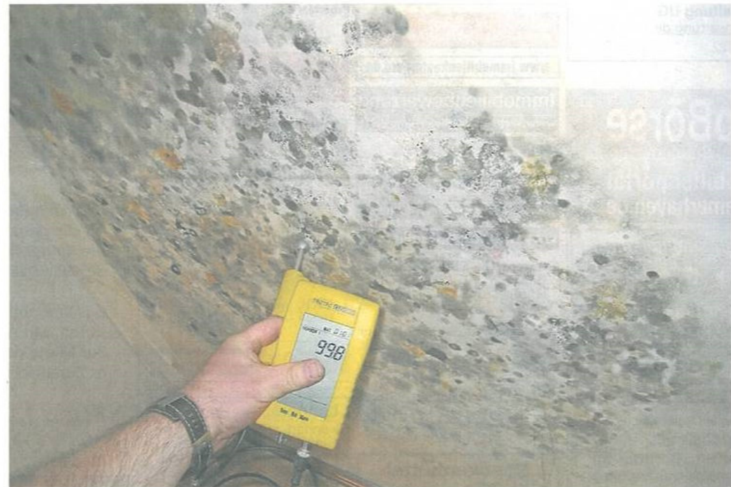
Zu viel Feuchtigkeit, niedrige Temperaturen – da hat Schimmel leichtes Spiel. So wie hier an der Wand hinter einem Kleiderschrank. Foto Torsten Dzeik /Energie-Fachberater.de
